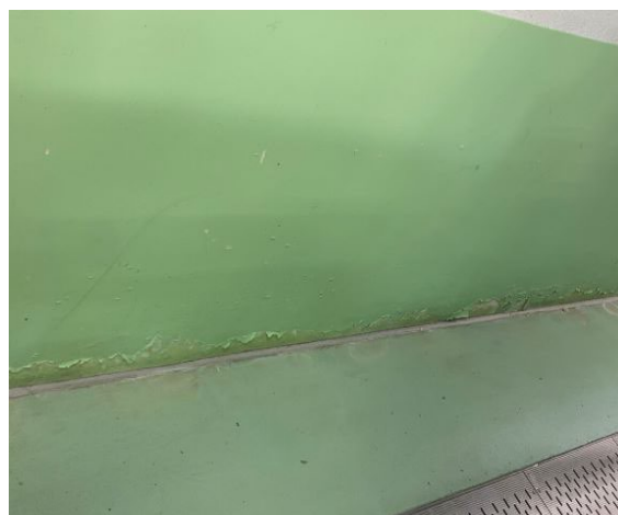
↑ 壁の塗装が剥がれ
